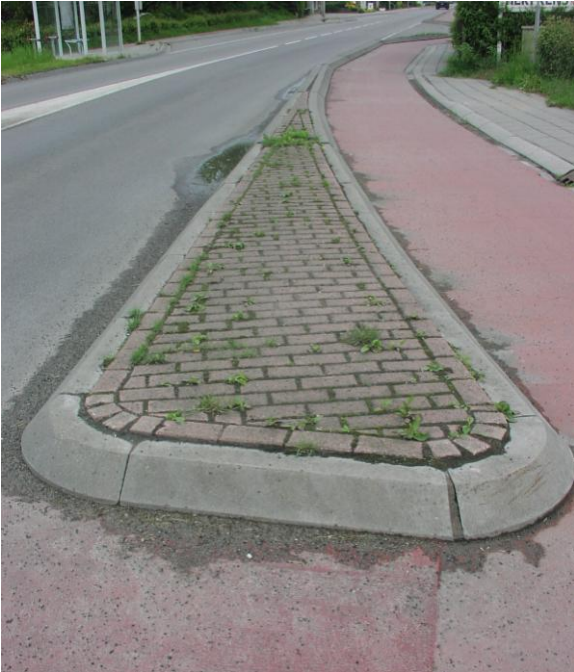
Verkeersgeleider niet behandeld met Protec dalle
